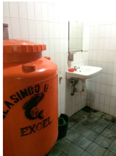
Gambar 7. Tangki air dari PVC fiberglass yang ada di hall-hall toilet.
