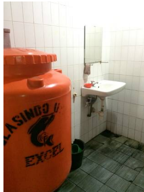
Gambar 8. Tangki air dari PVC fiberglass yang ada di hall-hall toilet.
